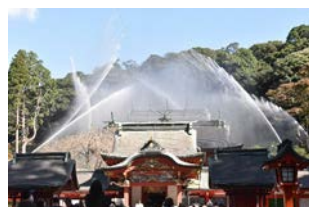
防災施設整備事業（放水銃等の整備） 【国宝・霧島神宮（鹿児島県霧島市）】
